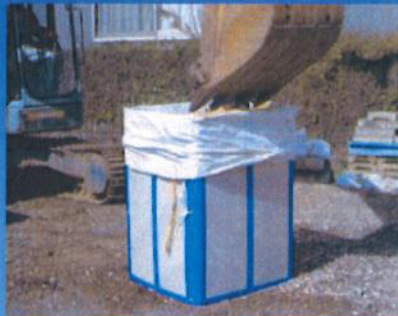
作業員不要で安全対策
